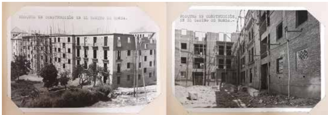
FIG. 9 / Fotografías de las obras paralizadas del tercer bloque (F2) del grupo del Camino de Ronda, 1941
