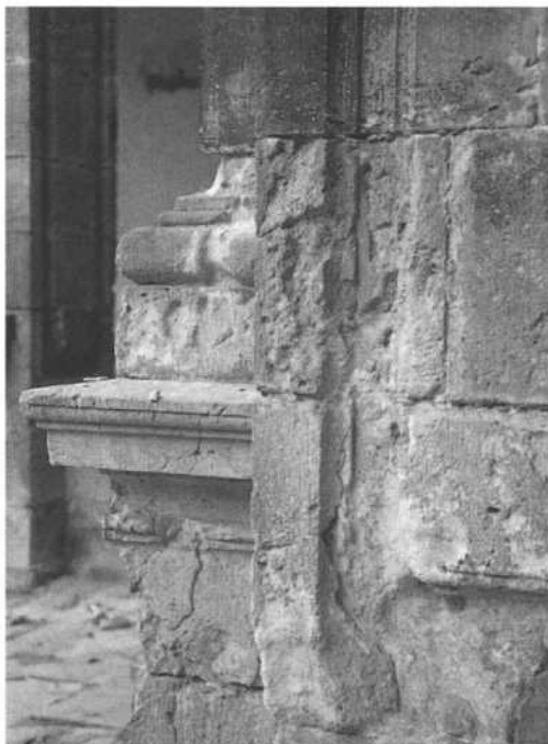
Deterioro visible del edificio del Colegio de Santo Domingo. Centro Histórico de Orihuela. Alicante.
