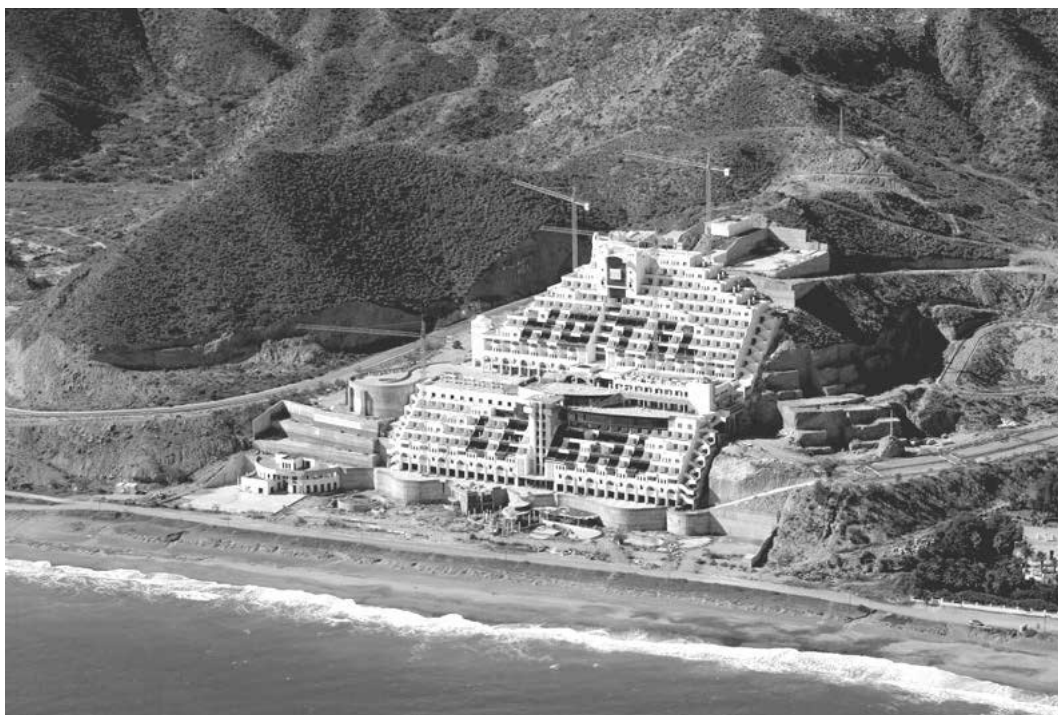
FIG. 5/ Hotel en construcción en la playa de El Algarrobo, en Carboneras (Almería)
