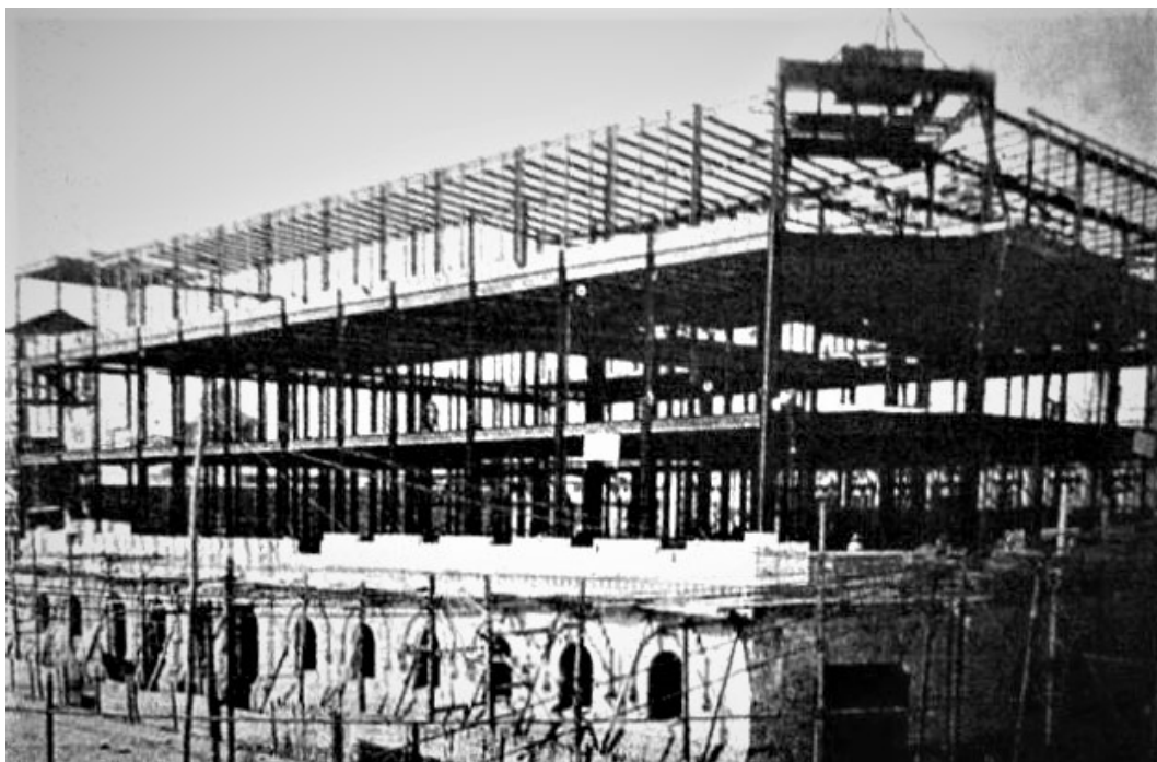
FIG. 12/ Esqueleto de acero en los cuatro pisos del Edificio de Correos. Sin autor, Ca. 1903
