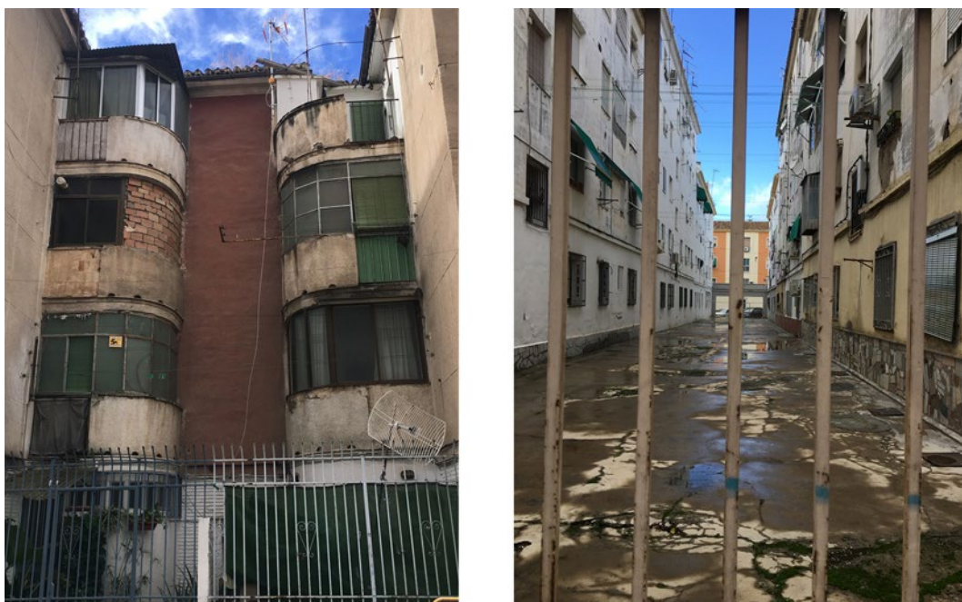
FIG. 2/ Edificios existentes a demoler por su mal estado de conservación y patologías asociadas.
