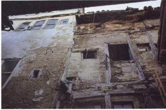
FIG. 5. Estado de deterioro de la edificación.
