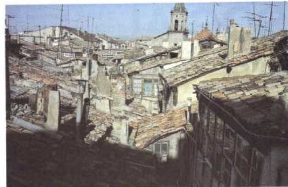
FIG. 4. Estado de deterioro de la edificación.
