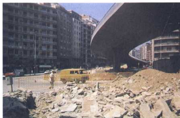
FOTO 13. En 1985 el Ayuntamiento decide derribar el tramo elevado de la Plaça Alfons X (*).
