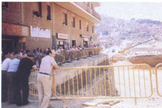
FOTO 21. Las obras del Cinturón dejan de ser conflictivas al lograr el consenso de los afectados (*).
