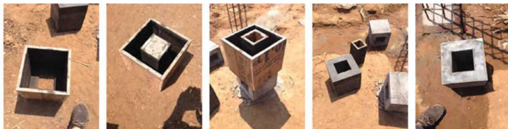
FIG. 7/ M.A.C. Arriba: asamblea de la comunidad local. Abajo: los bloques utilizado como parte del encofrado para los pilares de fundición.
