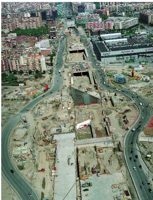
Estado de las obras en verano del 2006 con la nueva estación ya cubierta y las estructuras de la C-31 completas. Para garantizar la gestión eficiente de los más de 100.000 vehículos diarios de circulación fue necesaria una inversión superior a los 7 millones de euros.
