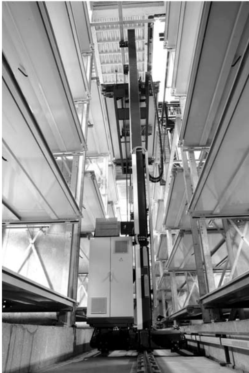
FIG. 19. Detalle de los mecanismos de elevación y recorrido bidireccional del sistema de aparcamiento “robotizado” utilizado en el edificio entre medianeras rehabilitado en la calle Lope de Vega 10 conformado por 12 viviendas VPO
