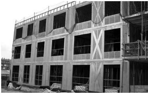
FIG. 13. Momento del montaje de 26 viviendas industrializadas de alquiler para jóvenes en Callús, resultado del Concurso de Innovación Técnica, INCASOL, de la Generalitat de Cataluña, realizadas con el sistema constructivo TECCON con empleo de paneles de entramado a base de perfiles de chapa de acero galvanizado
