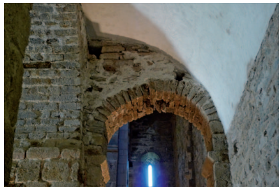
Figure 7. Warped arch and repaired key stones (made of bricks) in the monastery of Sant Quirze de Collera. Figura 7. Arco deformado y claves de arco reparadas (realizadas con ladrillo) en el monasterio de San Quirze de Collera.
