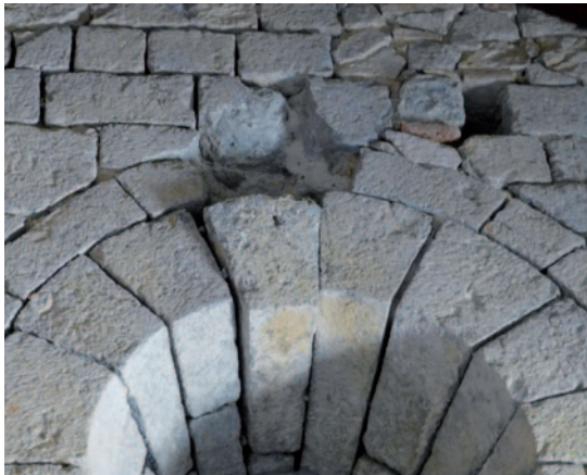
Figure 5: Key stones displaced horizontally in the refectory of the monastery of the Canonica of Santa María de Vilabertrán. Figura 5. Desplazamiento horizontal de las claves del arco en el refectorio del monasterio de Canonica de Santa María de Vilabertrán.
